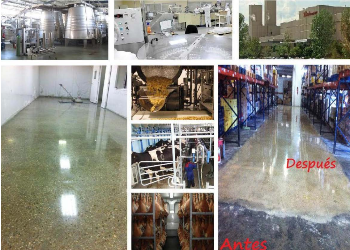
Instalaciones adaptadas a la Normativa mediante tratamiento de nanocrystalización.
